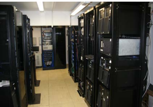
Atual data center do TJMA deve ser substituído
