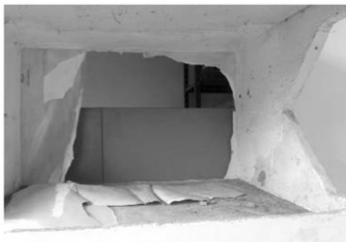
Buraco feito na parede, na caixa do ar-condicionado, por onde os bandidos entraram
