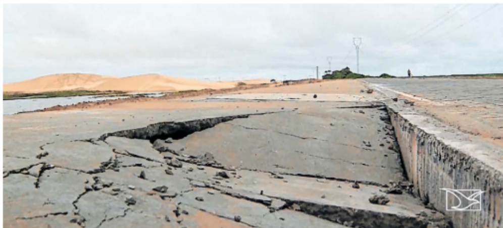
IA-315 com o pavimento deteriorado, mesmo tendo sido entregue há pouco mais de dois meses, em 15 de janeiro, pelo Governo do Estado
