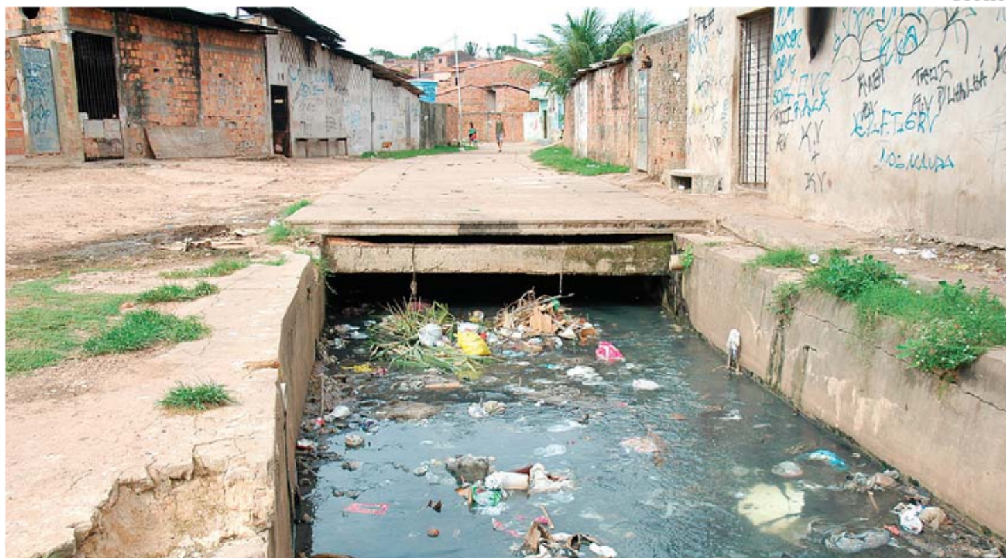
Na Rua da Felicidade, no João Paulo, há uma vala que acumula lixo e esgoto, causando transtornos
