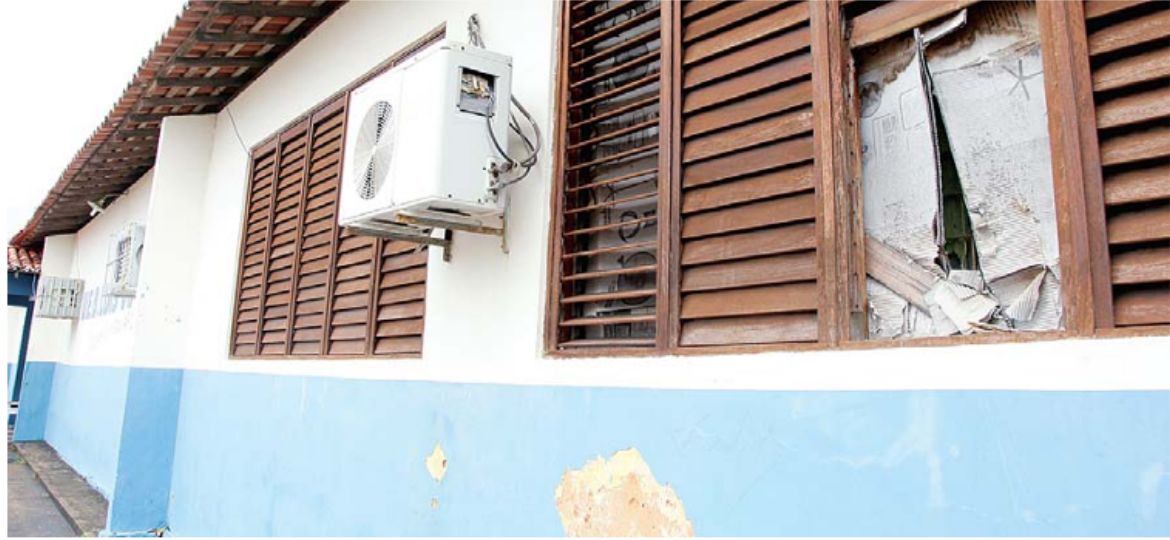
Com janela quebrada, segurança de escola fica comprometida, deixando alunos expostos a perigos
