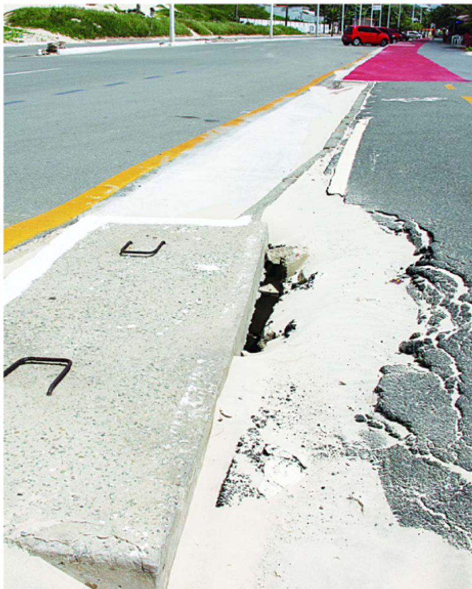
Trecho recém-recuperado da Avenida Litorânea com buracos
