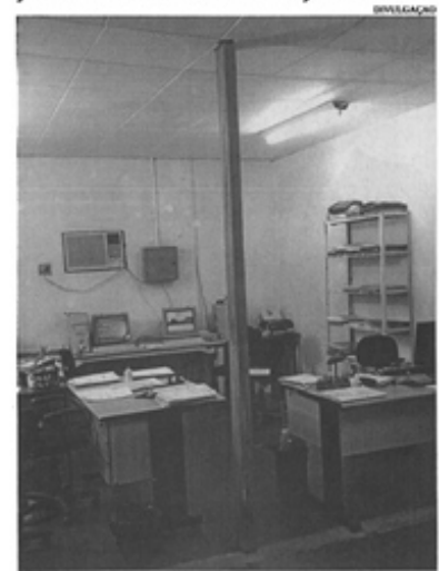
Em Matões, viga no meio da sala sustenta o teto
