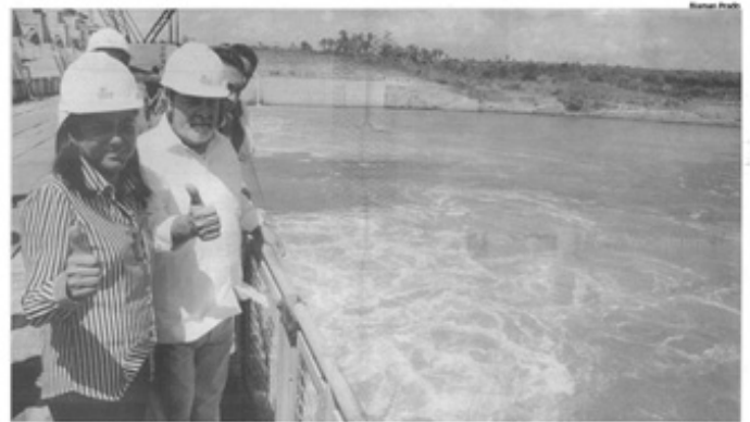
Roseana e Lula fazem sinal de positivo no canteiro de obras da Usina Hidrelétrica Estreito, antes de acionar o fechamento da primeira comporta
