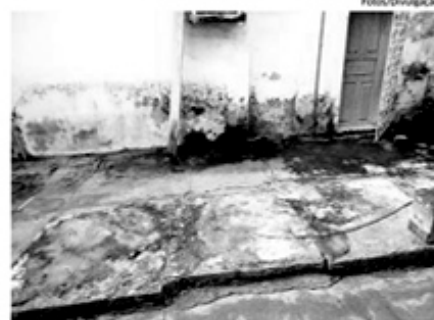
Fossa tem problemas e escorre a céu aberto, causando mau cheiro
