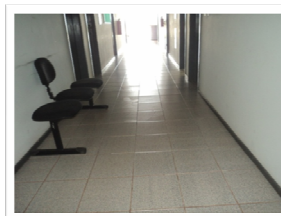
ANTES – PISO DESGASTADO
