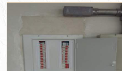
5º JUIZADO (UFMA) - Substituição do QGBT
